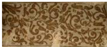
Lüneburg, In der Techt 2a, Decke,
