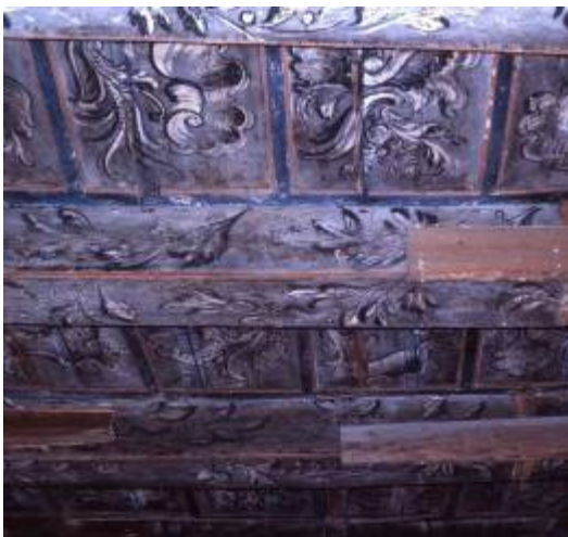
Abb. 17 Deckenmalerei im Obergeschoss von Große Petersgrube 29, 1740-60. Auf graublauem rechteckigem Grund liegt je eine Rocaille in Grisaille, die Rahmenleisten dunkelblau, innen das Profil durch roten Streifen abgesetzt. An den Balkenseiten Lorbeerzweige mit kleinen Früchten in Grisaille auf graublauem Grund.
