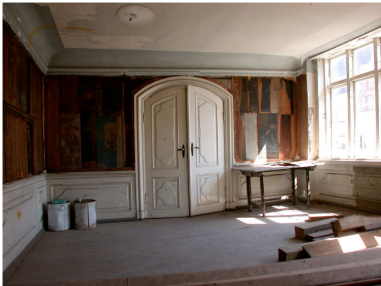
Abb. 19 Engelsgrube 74, Doppeltür im Obergeschoß führt auf dieser Seite in eine kleine Kammer, gegenüber liegt sie als Scheintür auf der Wand.
