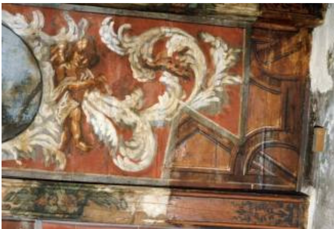
Abb. 15 Wahnstr. 33: Deckenmalerei im Seitenflügel Hochparterre. Die gemalte Kassettendecke aus der Erbauungszeit des Seitenflügels um 1570 – sichtbar in ocker-braun-Tönen rechts – wurde um/nach 1700 übermalt mit „bewohnten“ Akanthusranken, die ovale Bildfelder mit Landschaftsdarstellungen rahmen.
